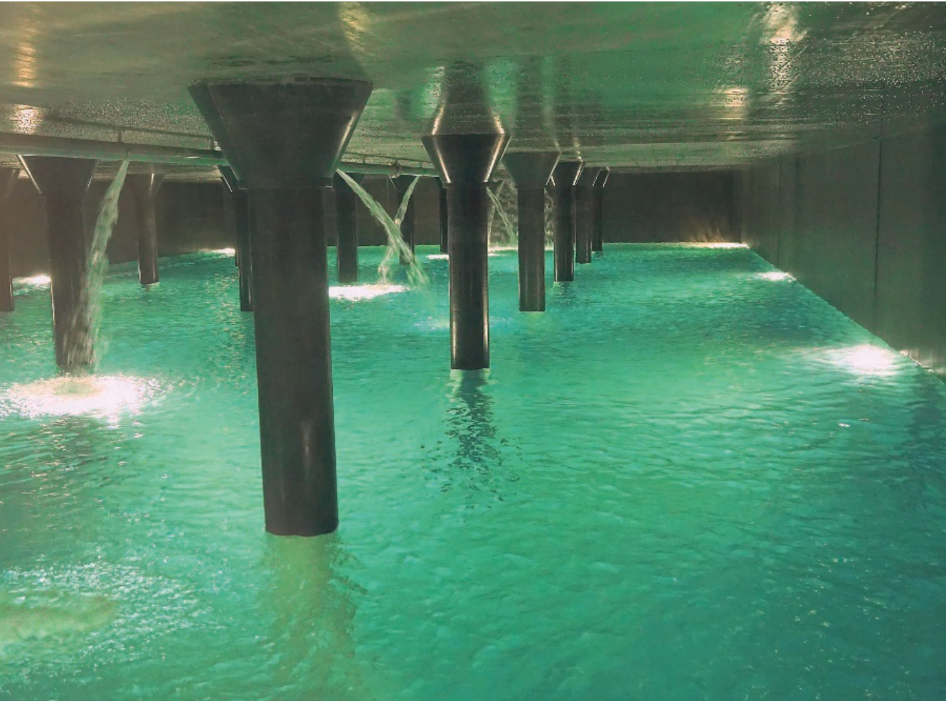
Allein im Wasserreservoir Tambel oberhalb Wallisellen sind 10 Millionen Liter Wasser gespeichert.
