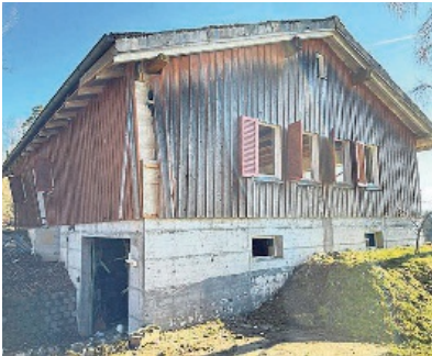
Ein beschädigtes Gebäude. BILD KAPO ZÜRICH
