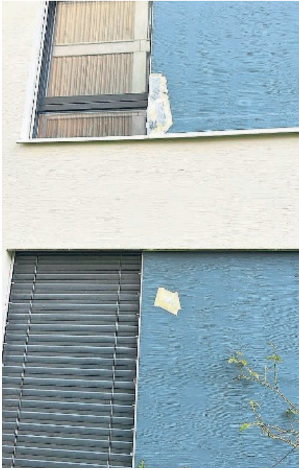
...und die beschädigte Fassade.
